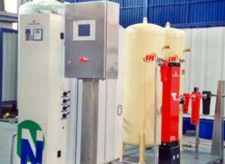
Generador de nitrógeno
